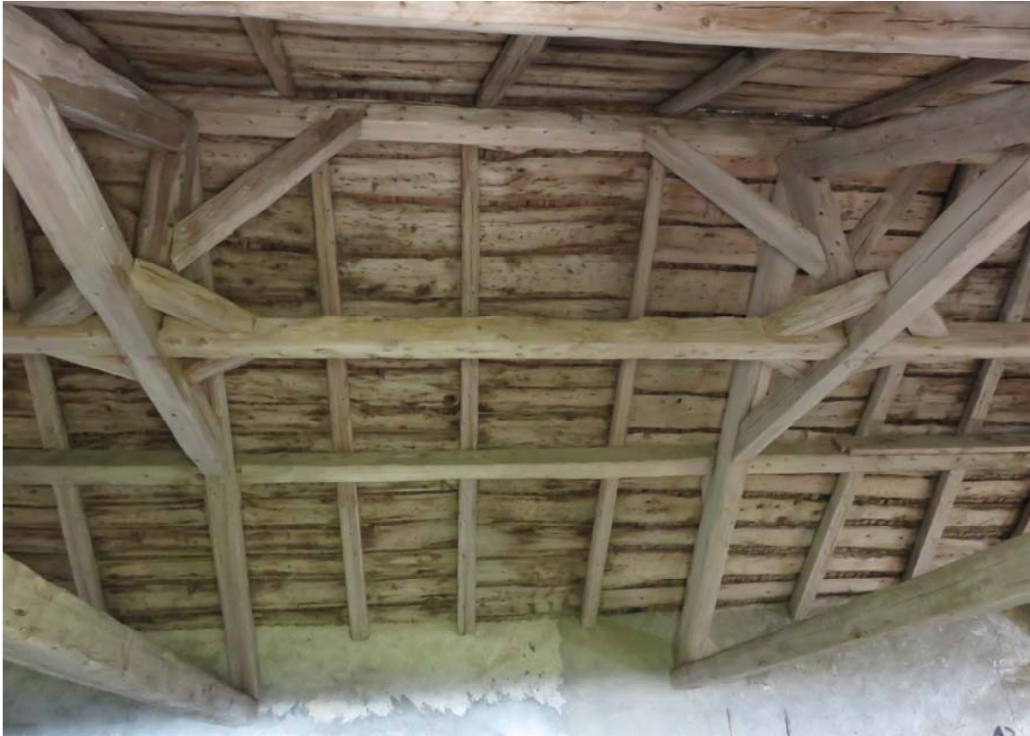
La poutraison, protégée par ses tôles ondulées, à l'abri de toutes les intempéries, est prête à durer des siècles.
